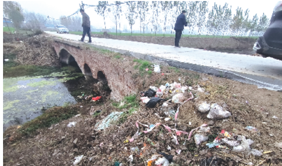
淮阳区朱集乡张山楼村西侧桥两头堆积大量生活垃圾
