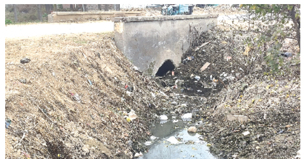
淮阳区刘振屯镇x015科教路东侧路沟内污水横流,有白色垃圾漂浮
