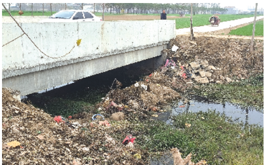
淮阳区刘振屯镇王三楼村南西蔡河桥两侧堆积大量各种垃圾
